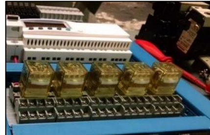
Figura 4.13. Tablero simulación PLC Zelio.
