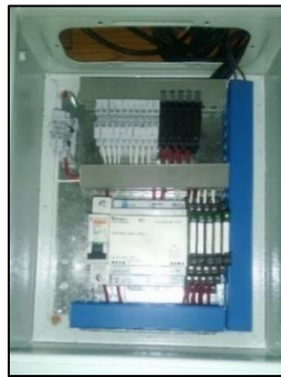
Figura 4.17. Tablero usuario vista interior.
