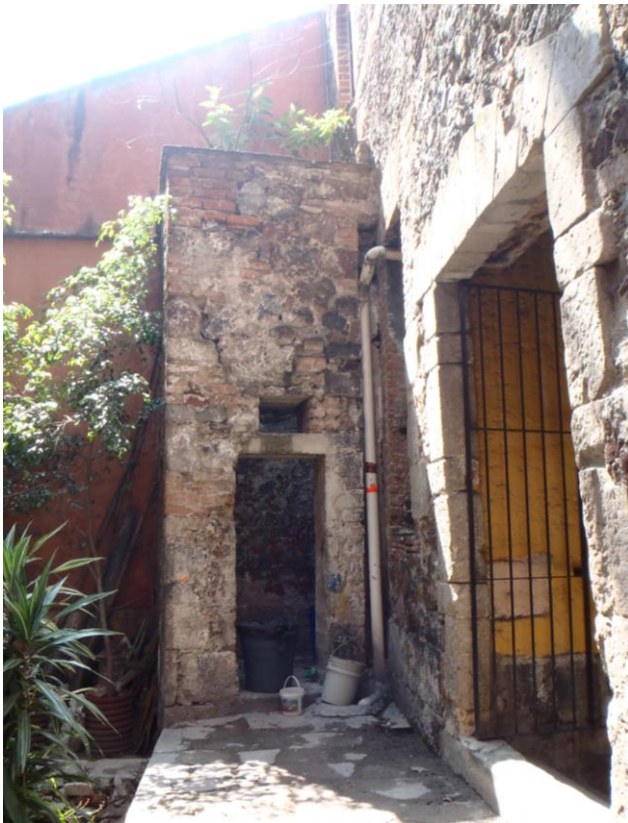
Imagen de los restos de la Calera u horno para piedra caliza. Fuente: Pertenece al archivo fotográfico de nuestra investigación (2013).
