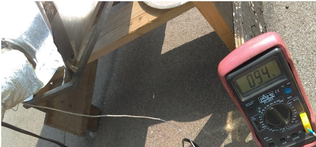
Fotografía 15 Termopar para determinación de temperatura a la entrada del evaporador.
