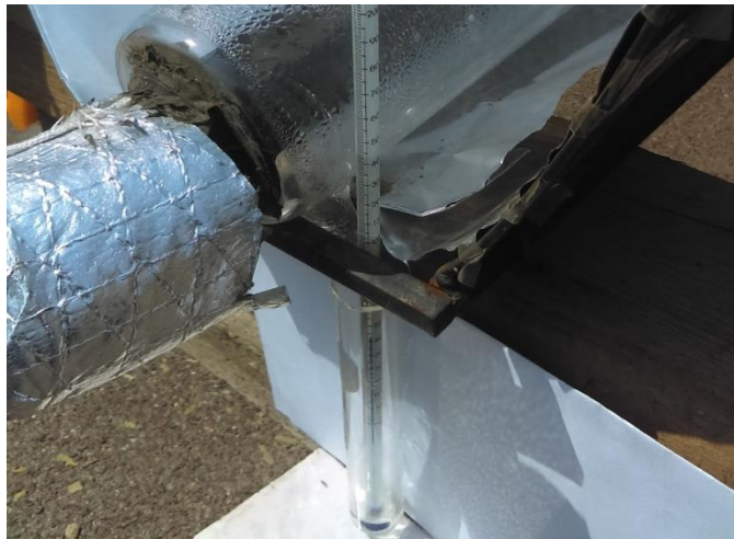
Fotografía 19 Determinación de la temperatura de salida del condensado
