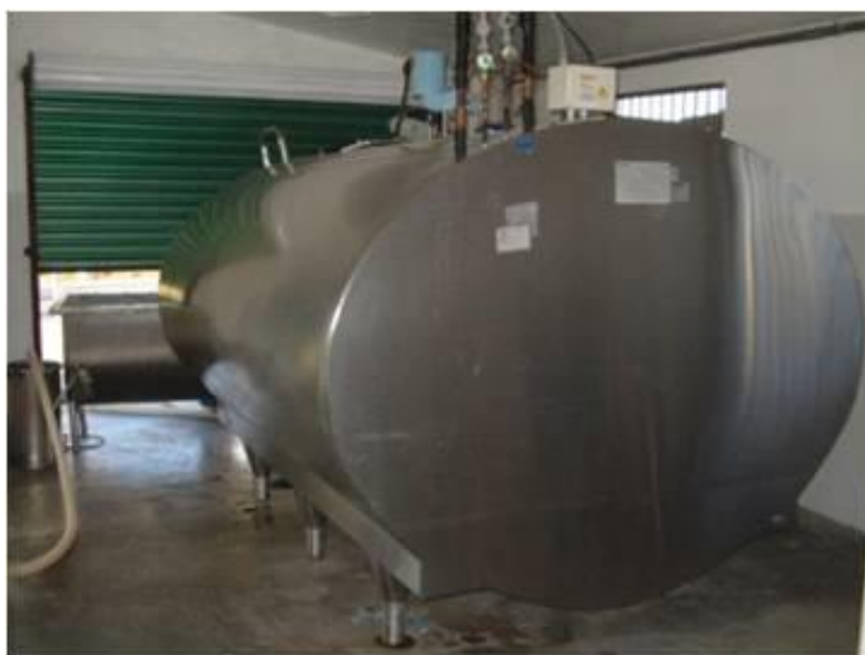
Tanque enfriador para almacenar la leche. Foto: Archivo SEDAC
