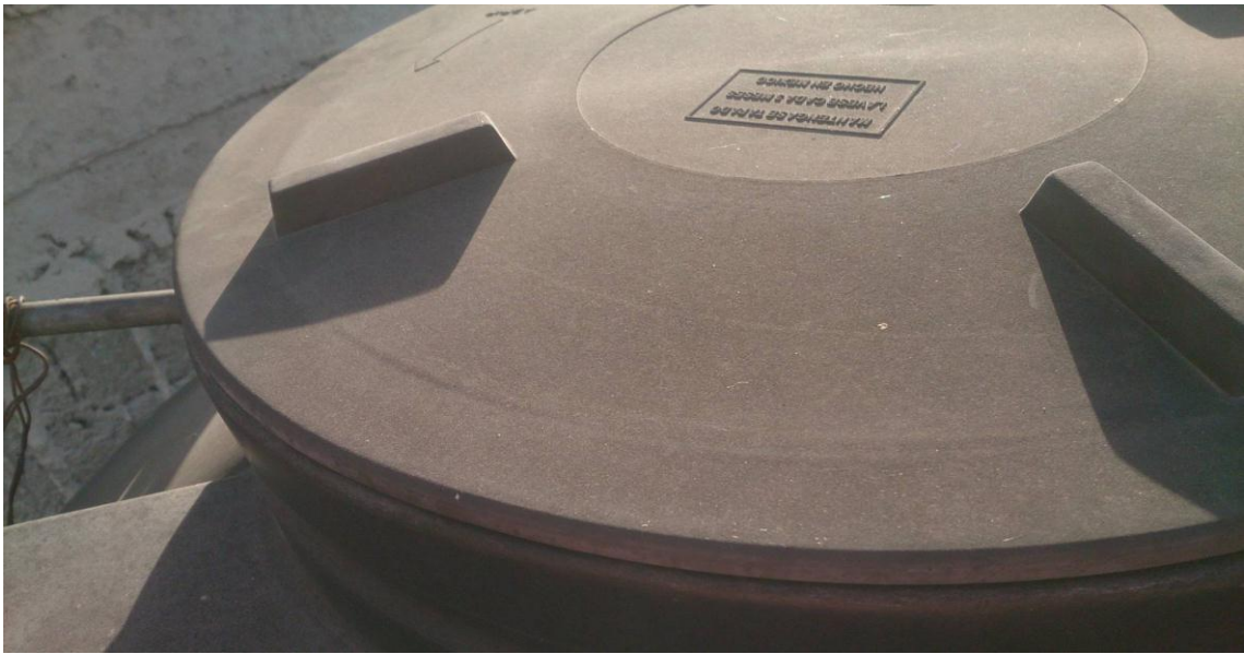
Figura 8. Tinaco de agua de la escuela cetís n. 7
