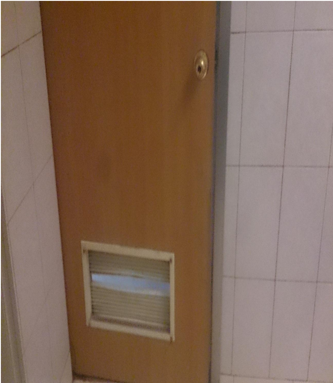
Figura. 23. Puerta de los sanitarios se ve con una ruptura en la parte inferior.
