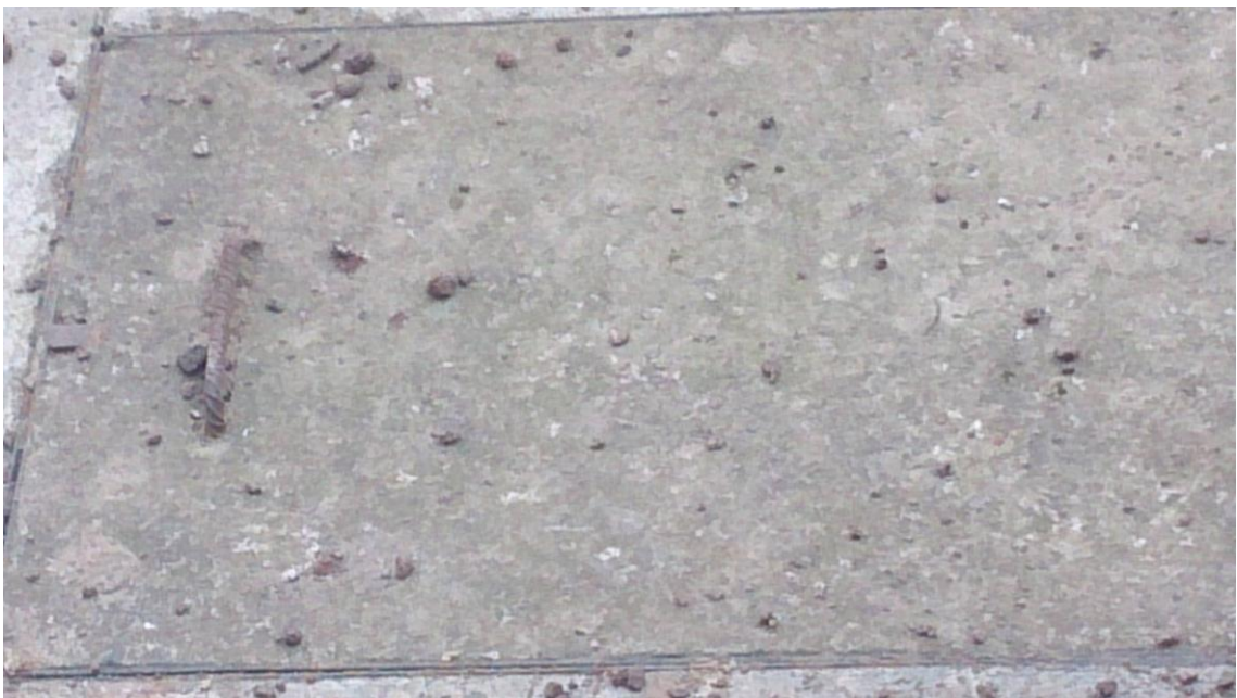
Figura 9. Registro de drenaje de la escuela cetís n.7
