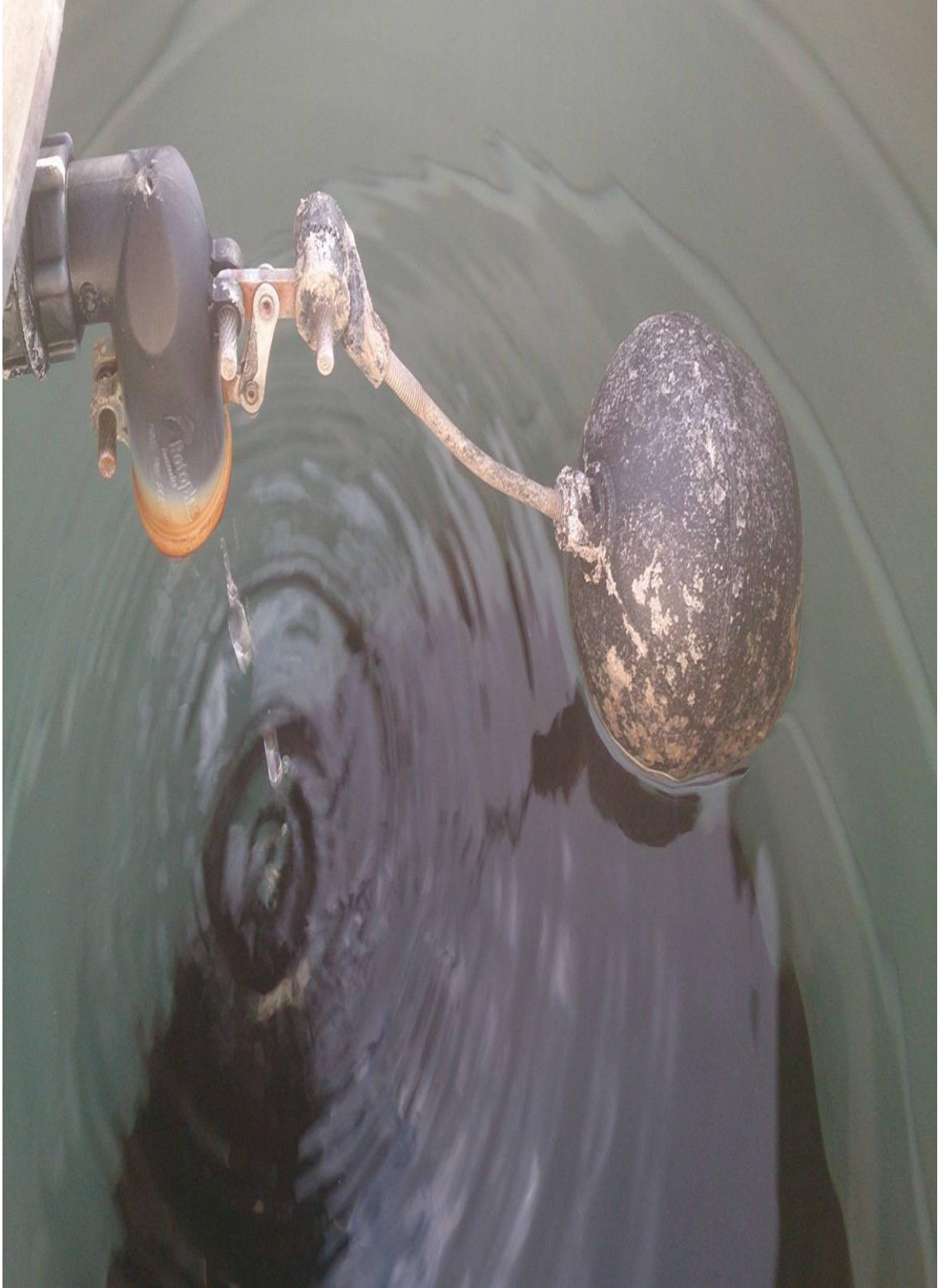
Figura 11. Flotador del tinaco de agua de la escuela cetís n.7
