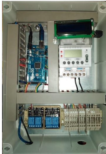
Figura 3.5: Tablero de control del sistema.
