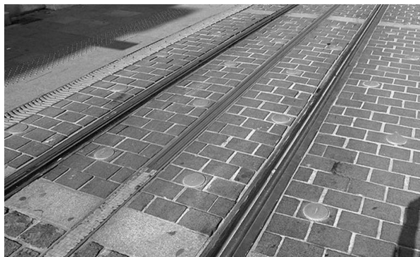
Tercer riel para el funcionamiento de los tranvías con tecnología APS.
