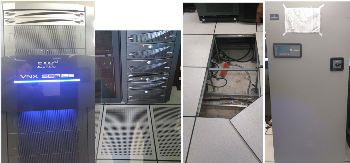
Fig. V.2. En un MDF: Servidores EMC 2 , piso falso, sistema Lieber de refrigeración.
