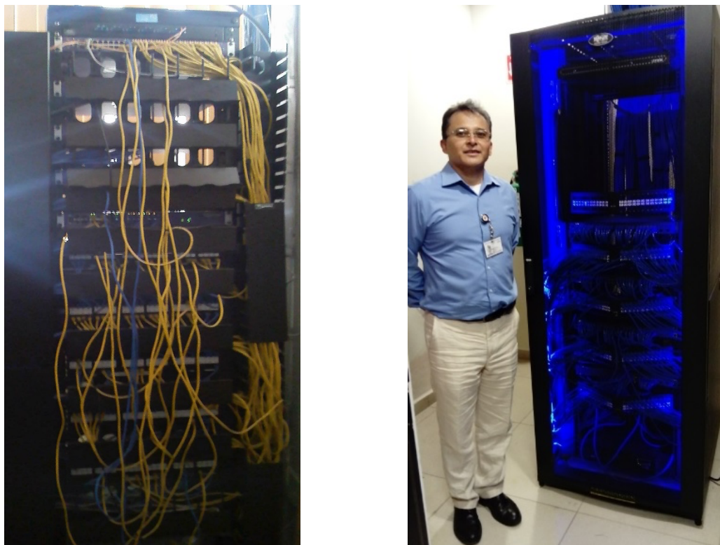
Fig. V.3. Rack dentro de un IDF. A) Cableado desordenado. B) Cableado según estándares (2021)
