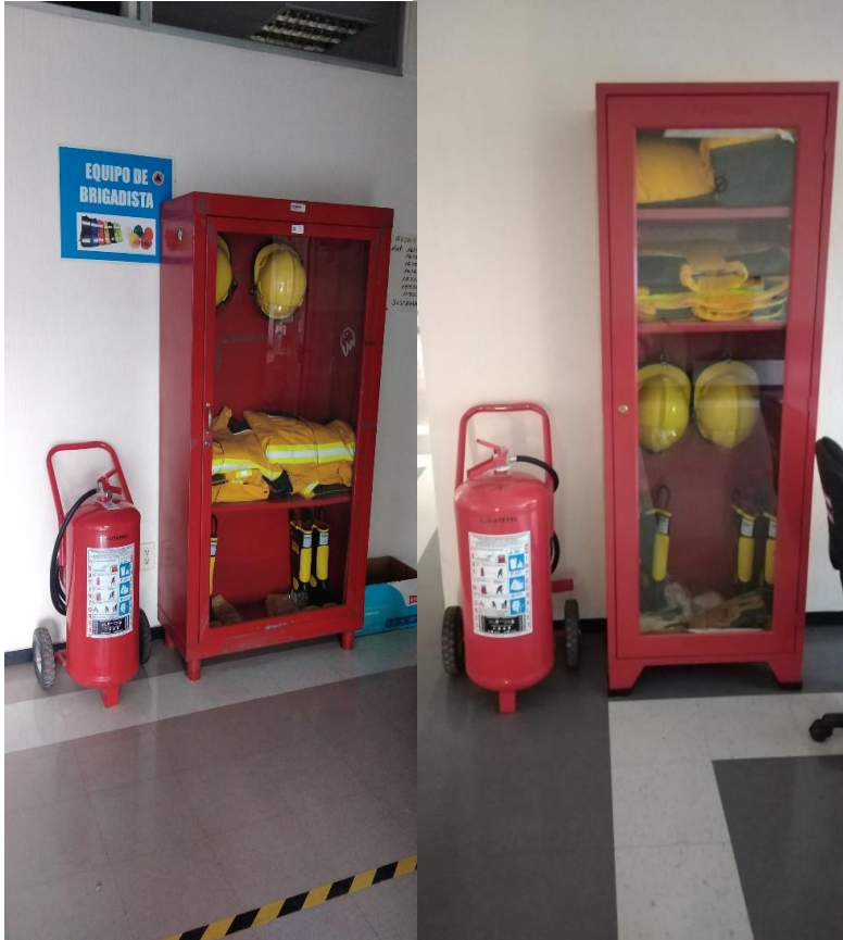
Gabinete con Equipo de protección personal. Cuautepec.
