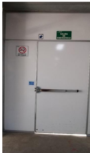
Fotografía 7. Salida de emergencia en cubículos de profesores. San Lorenzo Tezonco.
