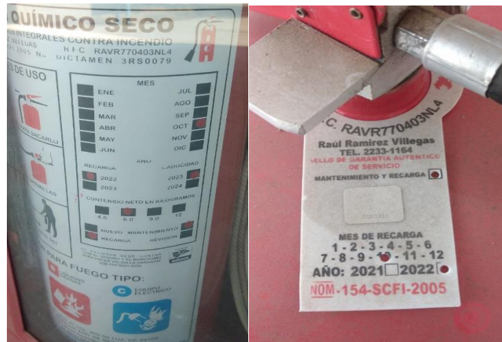
Fotografía 4. Etiqueta de identificación en extintores de CO2, con su última fecha de recarga.
