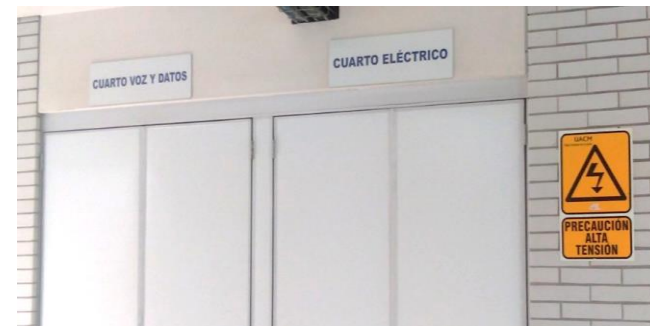
Precaución Alta tensión. Cuauhteppec
