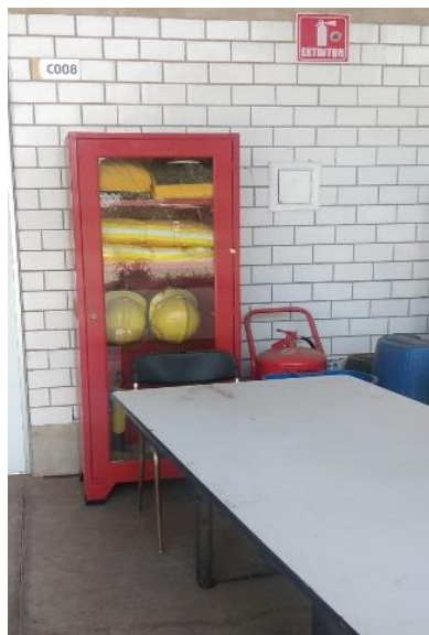
Fotografía 5. Visualización de gabinete y extintor bloqueados.
