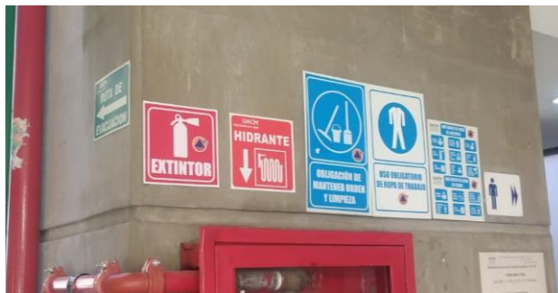
Extintor, Hidrante y Uso obligatorio de equipo de trabajo. Cuauhteppec.
