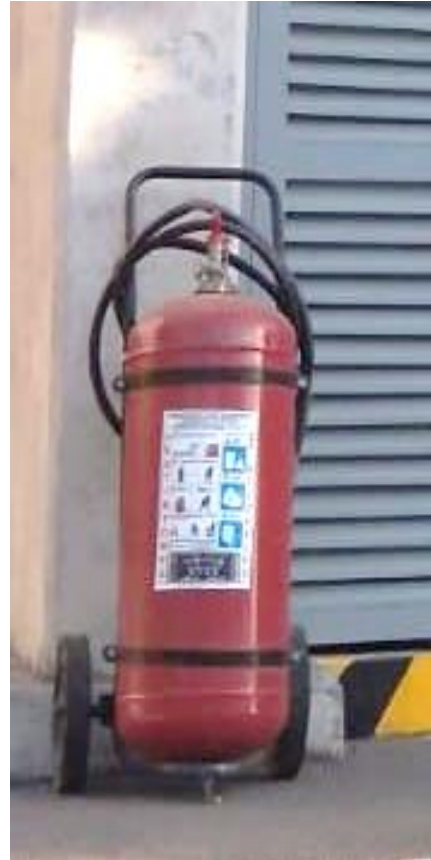
Extintor de CO2. Cuautepec.
