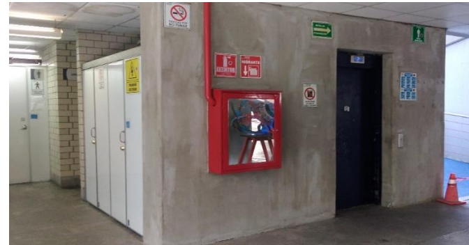
Señalización de Hidrante, Ruta de evacuación, Prohibido fumar, Precaución alta tensión y No pasar.
