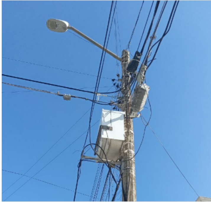
Figura 4.3.1: Infraestructura del servicio de TV de paga
