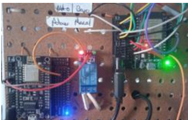
4.3: Figura N°36a. Foto al Encendido y pagado de la bomba y electroválvula.
