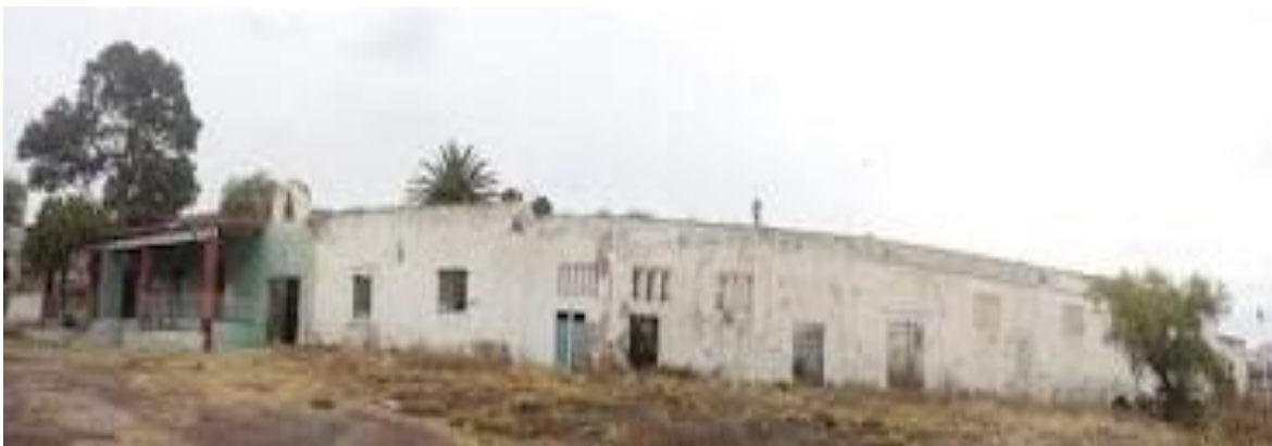
Ilustración 20 Imagen reciente del caso de la hacienda Cerro Gordo que da muestra del estado físico de la misma
