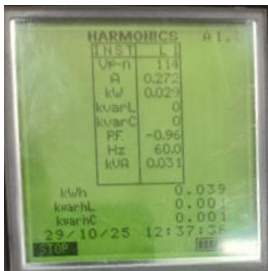
Figura 5.58 Condiciones de entrada al driver a 114v con analizador de red eléctrica.
