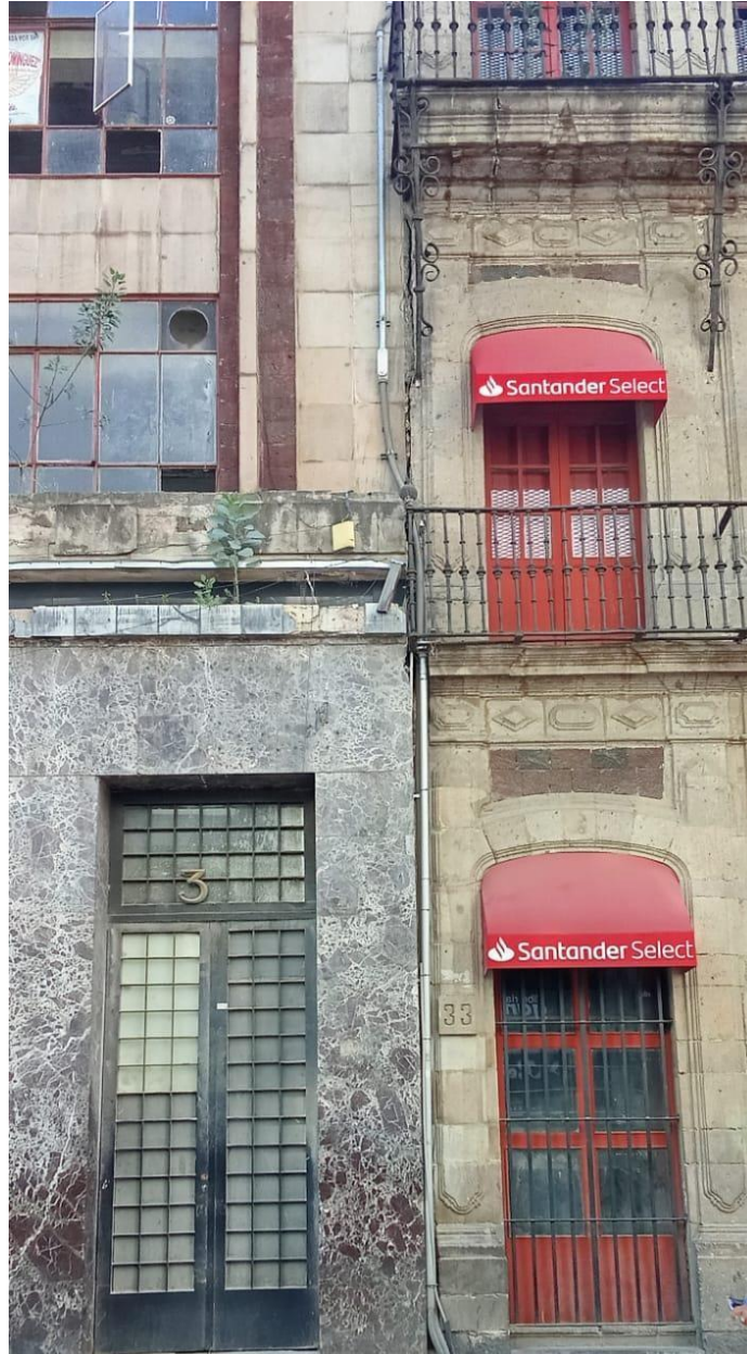
A la izquierda, fachada de edificio deteriorado a la derecha Banco. Madero 33 entre Bolívar y Motolinía. Fotografía del autor. 20 de septiembre de 2025.
