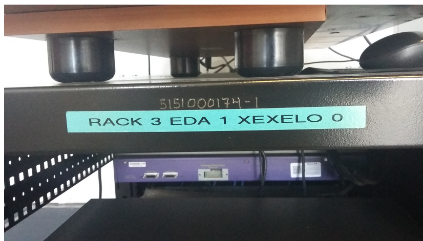
Figura 3.4: Etiquetado del rack en el que se encuentra el clúster Xexelo0.
