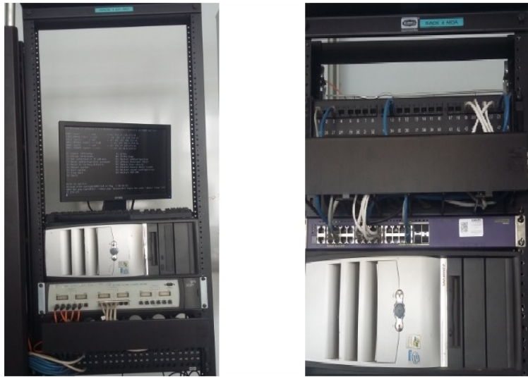
Figura 3.5: Firewalls del laboratorio B-404.
