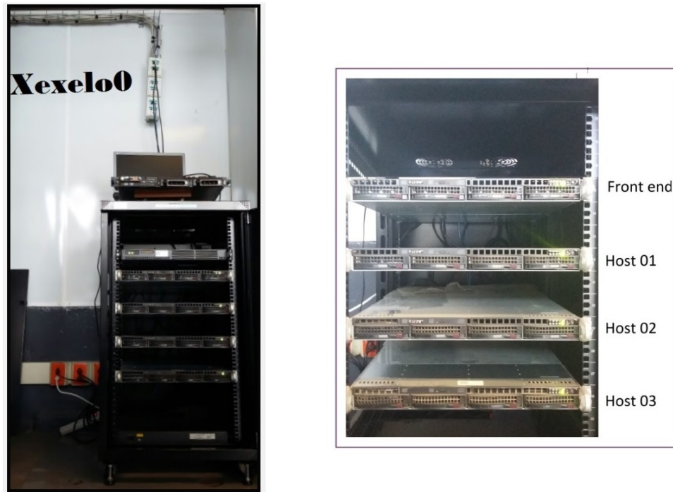
Figura 3.3: Xexelo0 en laboratorio B-404. Del lado izquierdo se aprecia el rack, del lado derecho se aprecia un acercamiento a los servidores
