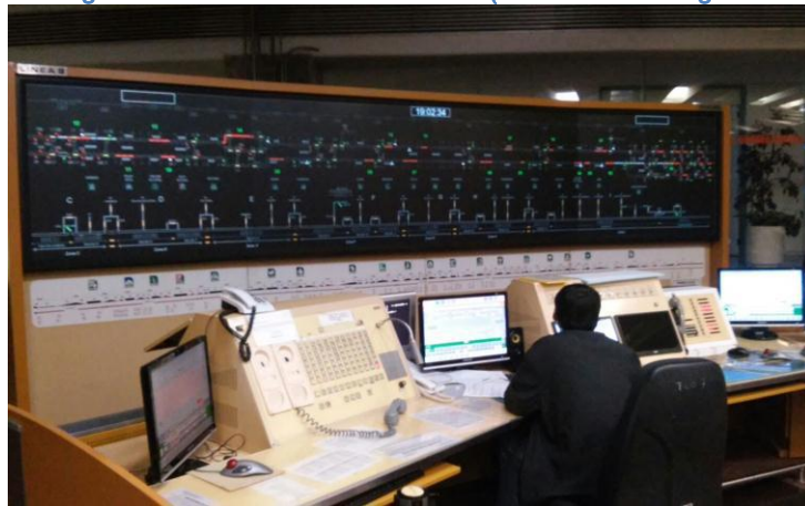
Foto 18 Regulador del PCC en TCO línea 8 (Por Arturo Rodríguez Villegas)
