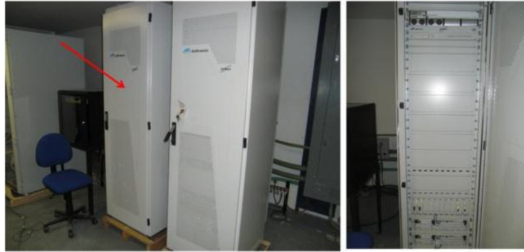
Figura 29 Armarios de Conmutación Central Descripción general de la red TETRA
