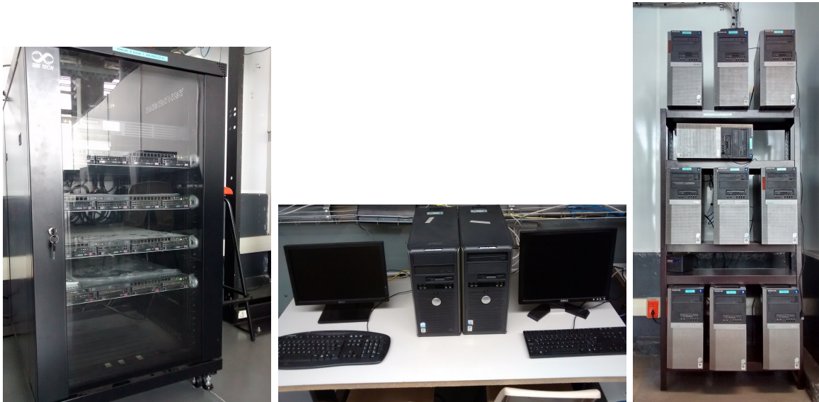
Figura 3.8: Clúster xexelo0, zona de administración y clúster xexelo1.
