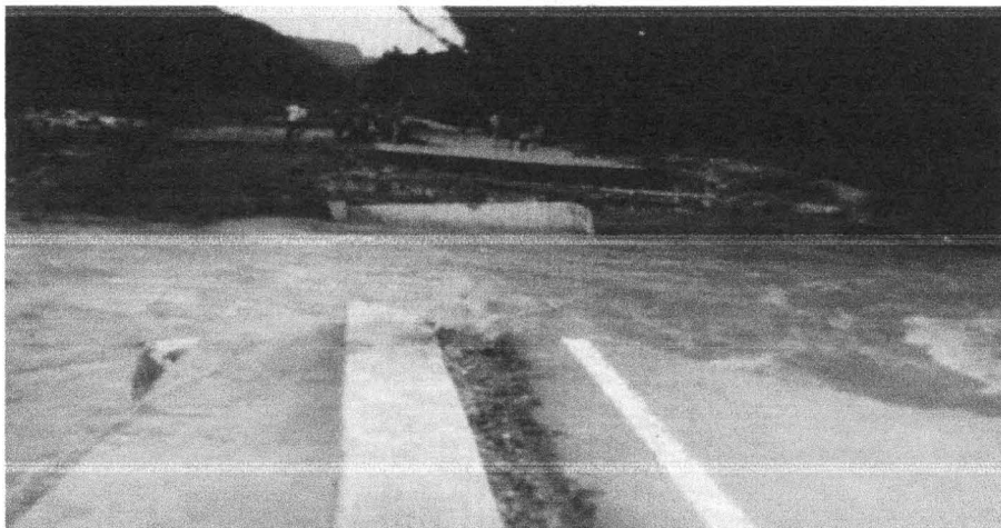
Foto no. 9. Se aprecia el puente totalmente derrumbado por la creciente y la fuerza de la naturaleza. Fuente: adquirida por el Anónimo 1.
